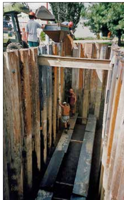
Obr. 12: Reaktivní brána pro sanaci znečištění v podniku Autopal Hluk v roce 2001 (Zakládání staveb, a. s.)
