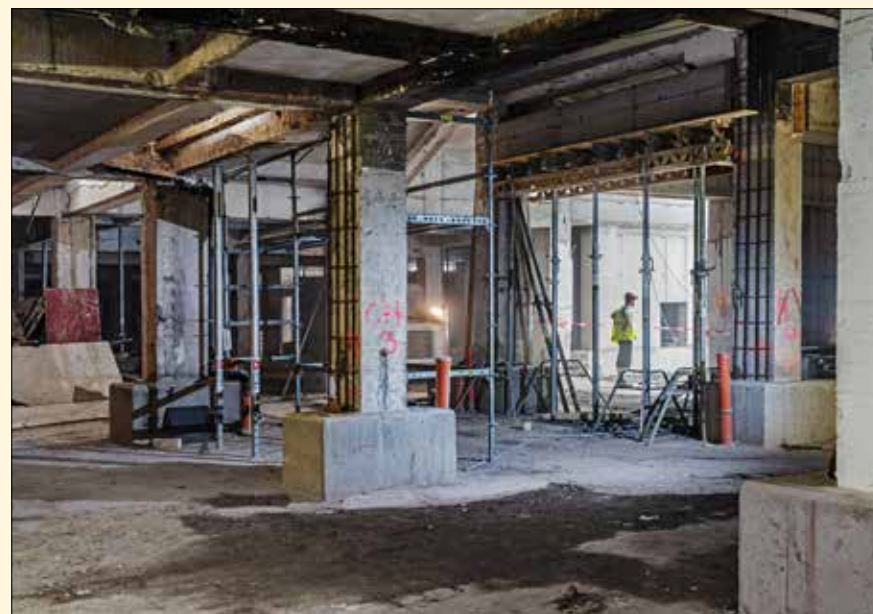
Podchycené a následně dodatečně vyztužované sloupky skeletu na 1. PP
