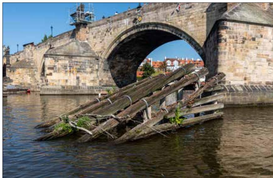
Původní ledolam v havarijním stavu
