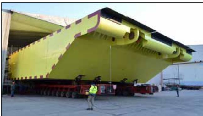
Přesun pohyblivé části bariéry k přístavišti
