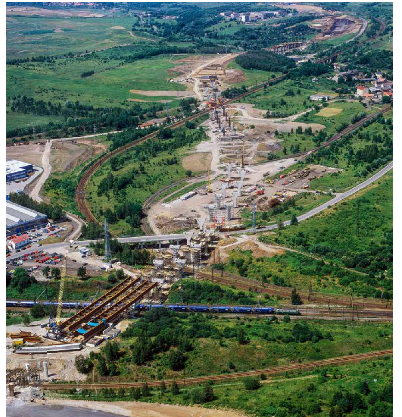
Dálnice D8, založení mostů přes tratě ČD v Trmčích a přes Ždírnické potoky
